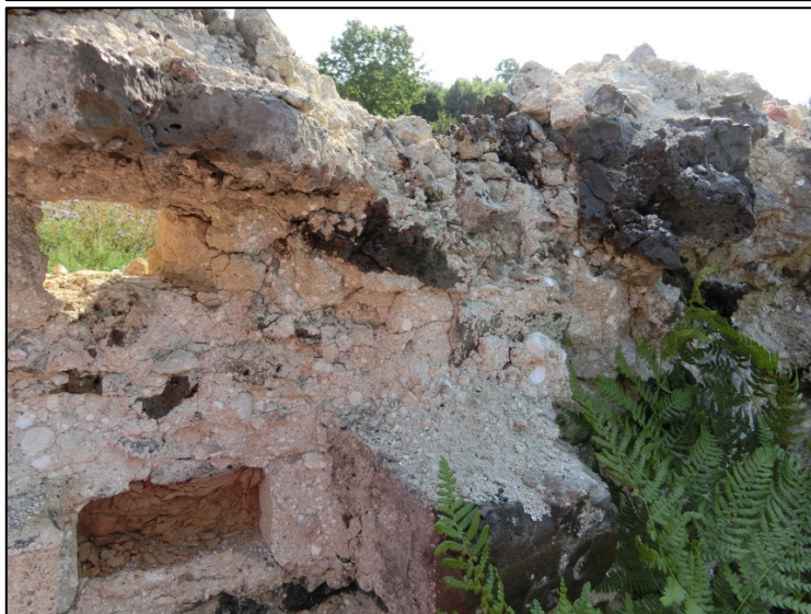
Där avtäckning saknas är muren i dåligt skick, med poröst, uppluckrat bruk och stora mängder nedrasat stöpmaterial.
